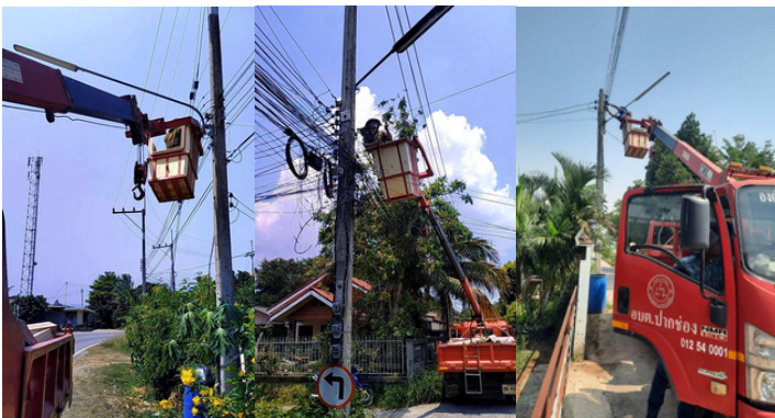
เดือนเมษายน 2567 กองช่าง อบต.ปากช่อง ดำเนินการซ่อมแซมไฟฟ้าแสงสว่าง ภายในตำบลปากช่อง จำนวนทั้งหมด 12 หมู่บ้าน
