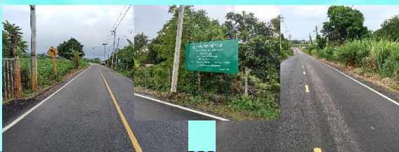
โครงการซ่อมสร้างถนนลาดยาง(เส้นเชื่อมหนองมะค่า) หมู่ที่ 1 บ้านคลองตาลอง
